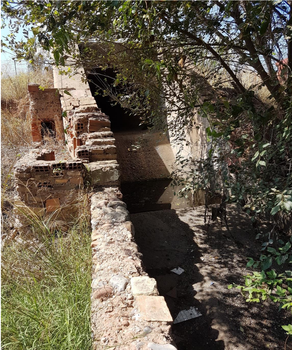
Ilustración 9" Foto detalle del colector de pluviales. Fuente propia"
