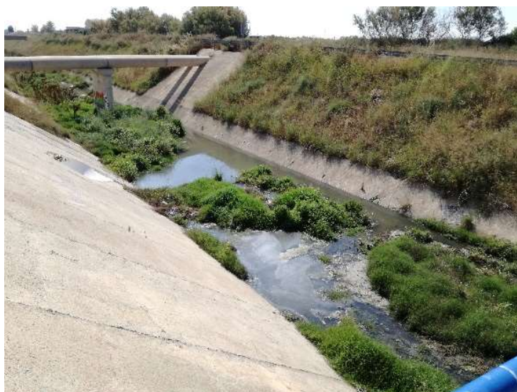
Figura 94. Canalización del Palmaret Alt y salida del colector de pluviales. Fuente: Autor.
