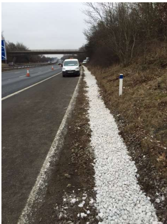
Figura 15. Ejemplo de filtro drenante paralelo al arcén de una carretera en Inglaterra.
