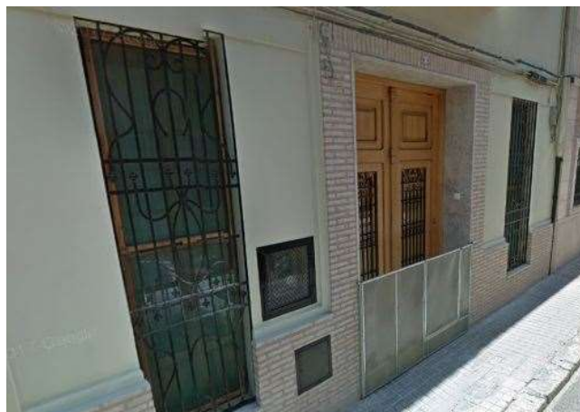
Figura 50. Barreras colocadas en entradas de las viviendas para protección frente al agua de lluvia. Fuente: Google Earth.
