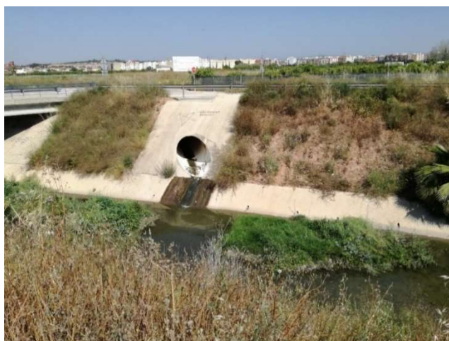
Figura 51. Salida del colector de pluviales y vertido al Palmaret Alt. Fuente: Autor.
