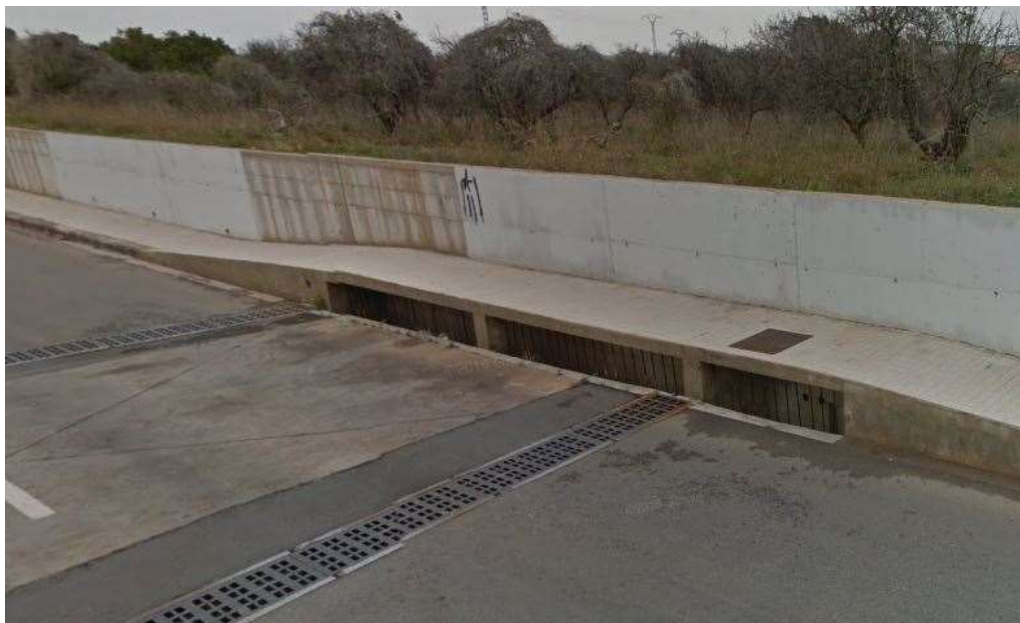
Figura 73. Sumidero de gran captación en la calle 130 conectado al colector de "la Defensa". Fuente: Google Earth
