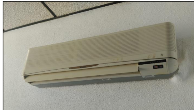
Figura 6 Aire acondicionado situado en la oficina
