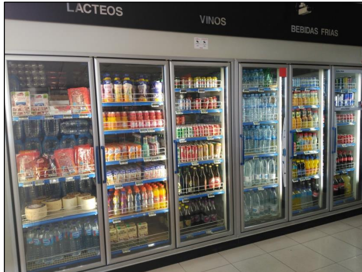
Figura 9 Cámara frigorífica de 6 puertas.
