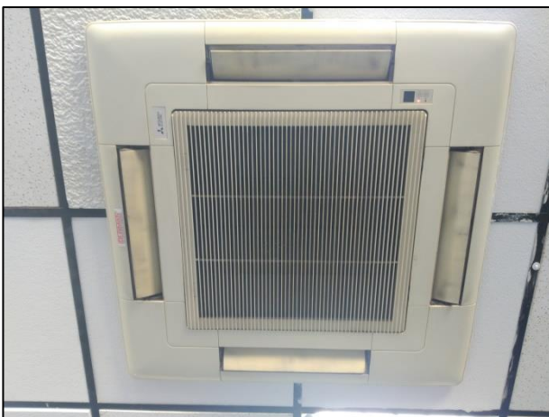
Figura 5 Aire acondicionado situado en la tienda
