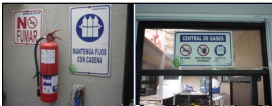
Figura 7 Señalización del cuarto de gases
