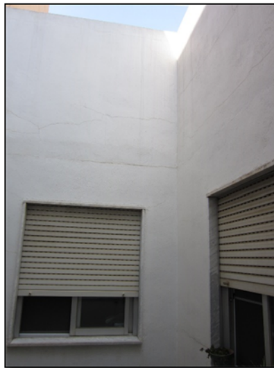
Figura 52. Fachada del patio de luces del edificio en estudio. Año 2017. Fuente propia.
