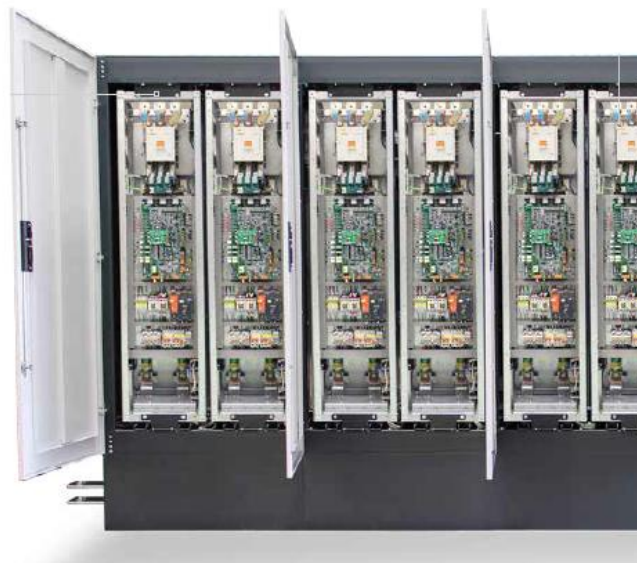
IMAGEN 8. INTERIOR DEL INVERSOR.
