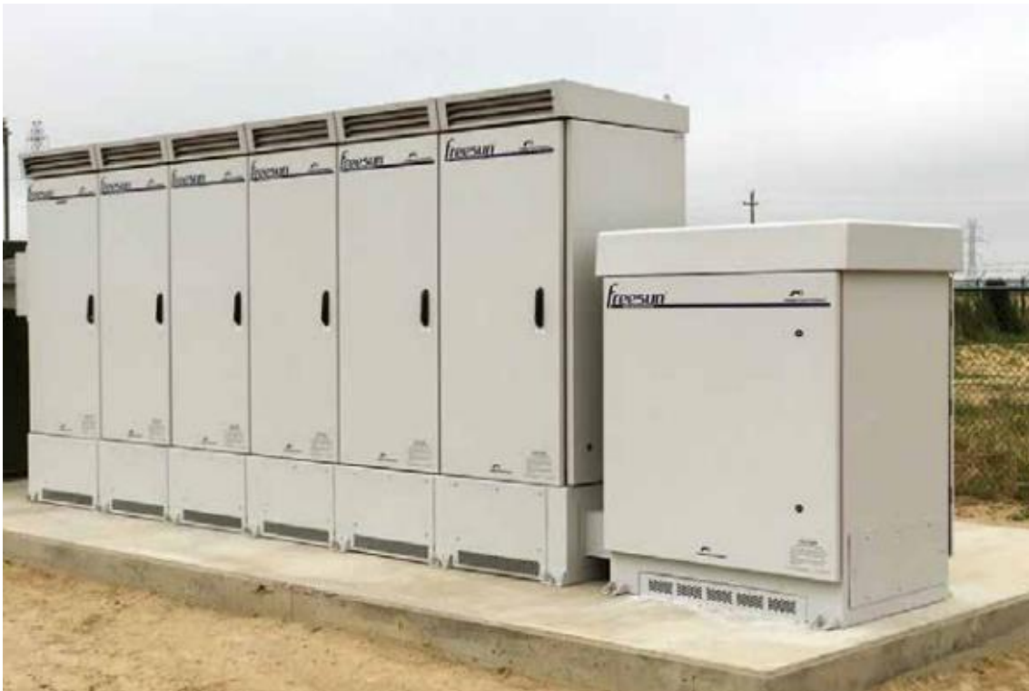
IMAGEN 1. INVERSOR OUTDOOR CON UNIDAD DE DESCONEXIÓN FUERA DEL EQUIPO.
