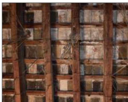
Figura 9. Forjado de vigas y listones con tablero de ladrillo. Alquería del Moro. Año 2016. Imagen propia.
