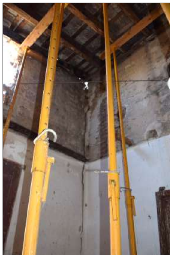
Figura 74. Grieta vertical nave 2C. Año 2016. Imagen propia.
