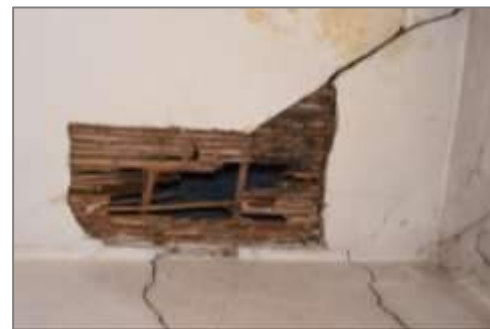
Figura 57. Falso techo de cañizo, sala 2DA. Año 2016. Imagen propia.
