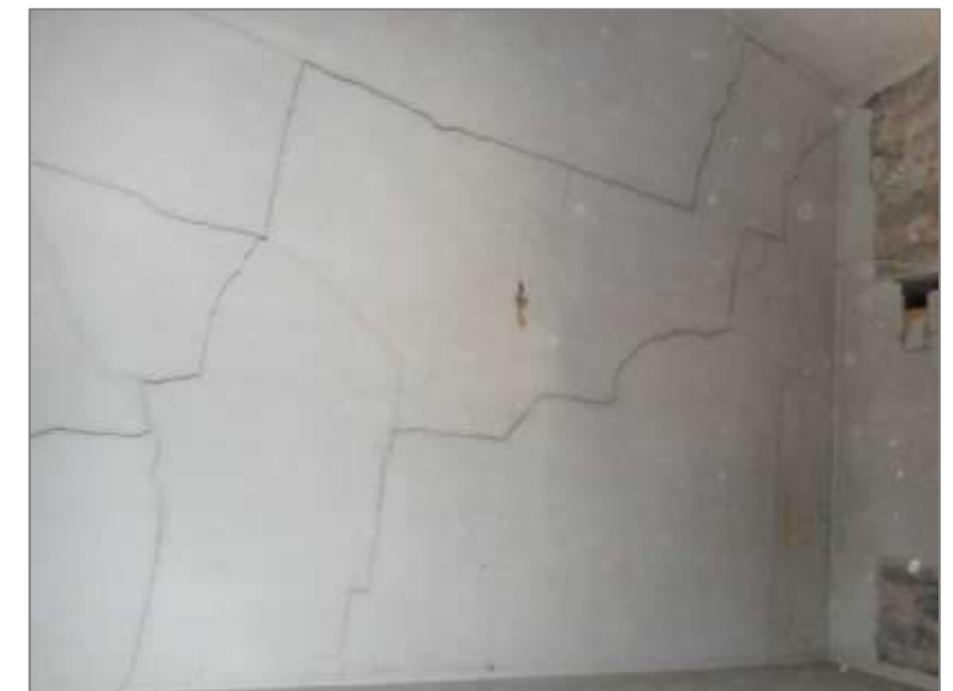
Figura 67. Fisuras sala 2DC. Año 2016. Imagen propia.
