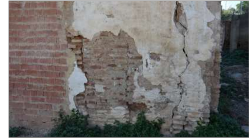
Figura 69. Patologías en esquina de fachada norte. Año 2016. Imagen propia.
