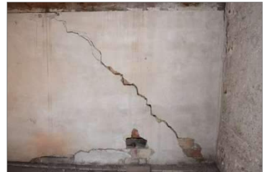
Figura 68. Grietas sala 2AA. Año 2016. Imagen propia.
