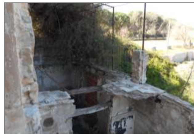
Figura 70. Derrumbe de forjado del mirador. Año 2016. Imagen propia.
