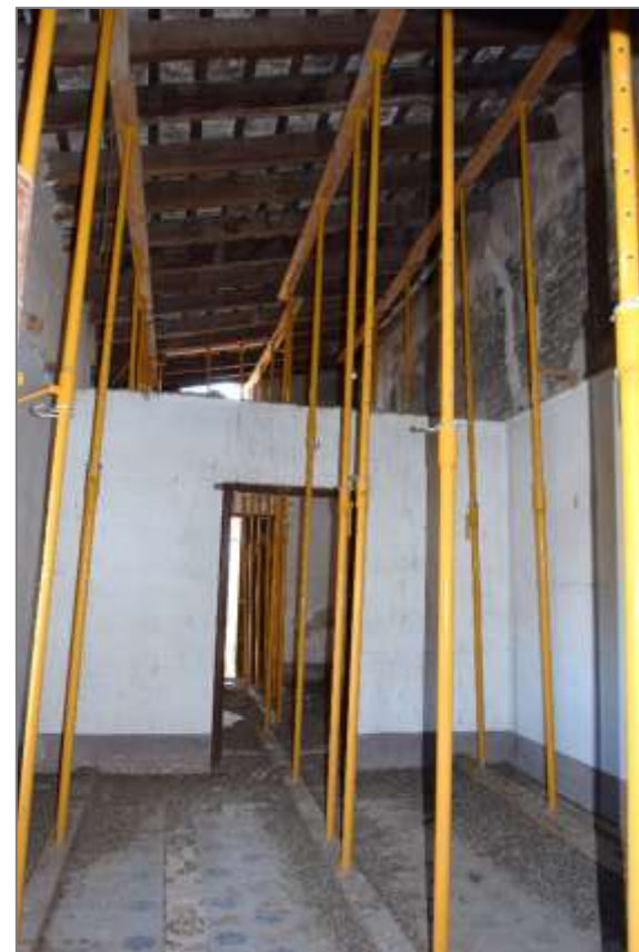
Figura 71. Inexistencia del antiguo falso techo nave 2C. Año 2016. Imagen propia.
