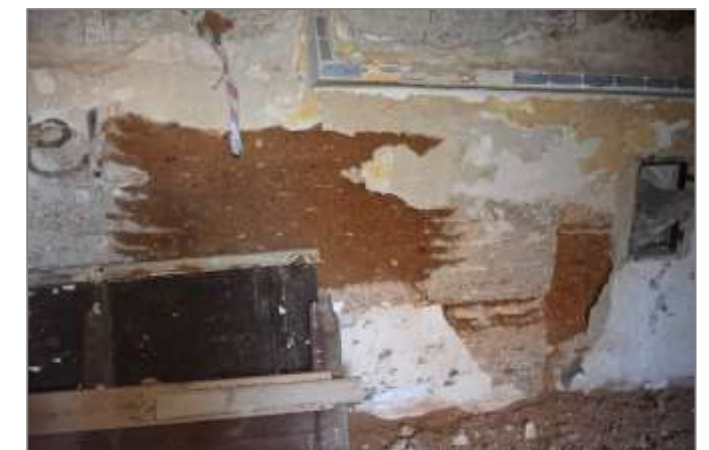
Figura 66. Pérdida de masa muro de tapia sala 1CC. Año 2016. Imagen propia.
