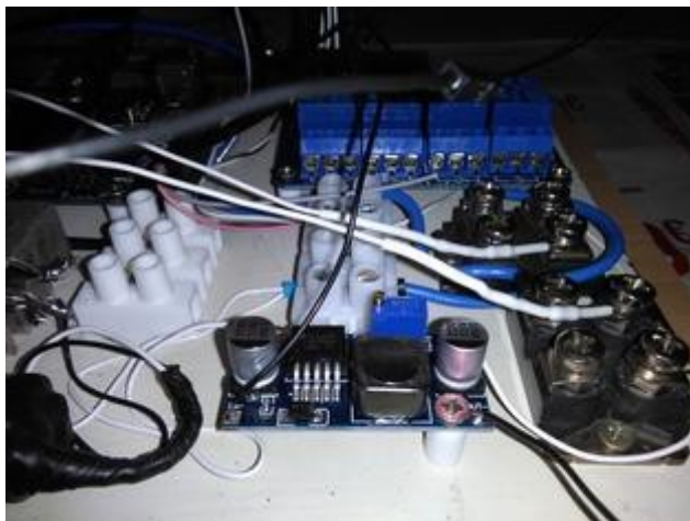
Vista del Módulo descender DC/DC Buck 30V-3V
