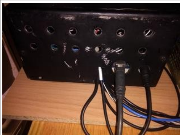
Vista final: parte trasera de la caja de control donde se aprecian los agujeros practicados para mejorar la ventilación; la ranura de salida de los cables; el conector USB; y el jack de alimentación del Arduino
