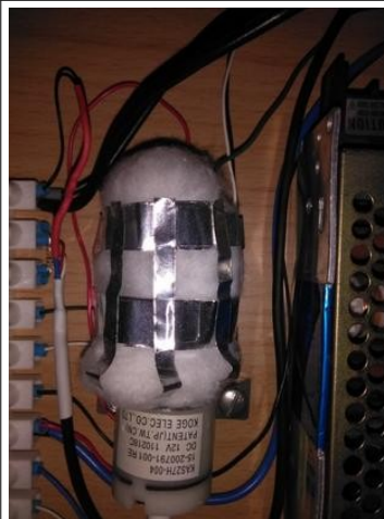
Vista de la bomba de aire con su filtro casero de algodón y cinta de aluminio
