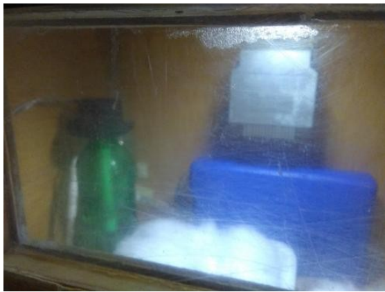
Observamos acumulación de humedad en el metacrilato de la ventana
