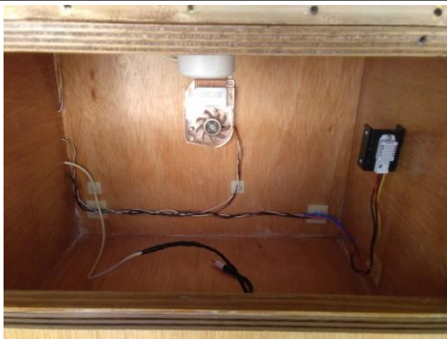
Vista completa con todo instalado
