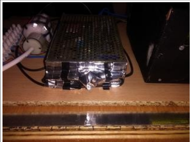
Vista final: con el trafo del humidificador y su cable pegados al chasis de la fuente (proceso de apantallamiento para solucionar interferencias)
