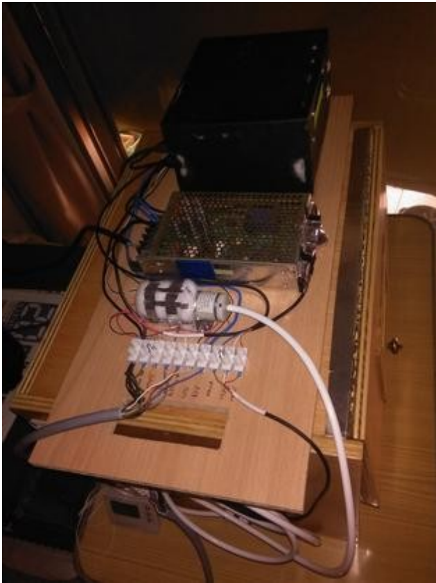
Vista final del tablero de control una vez finalizado todas la mejoras en el sistema
