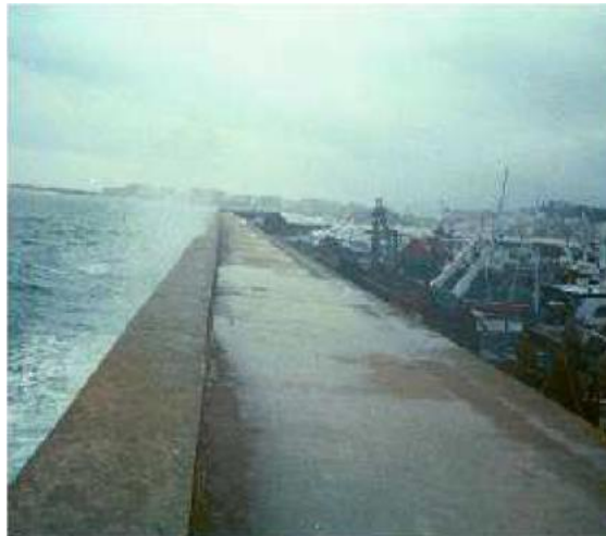
Figura 7. 9. Rebase excesivo sobre el dique principal de Blanes.
