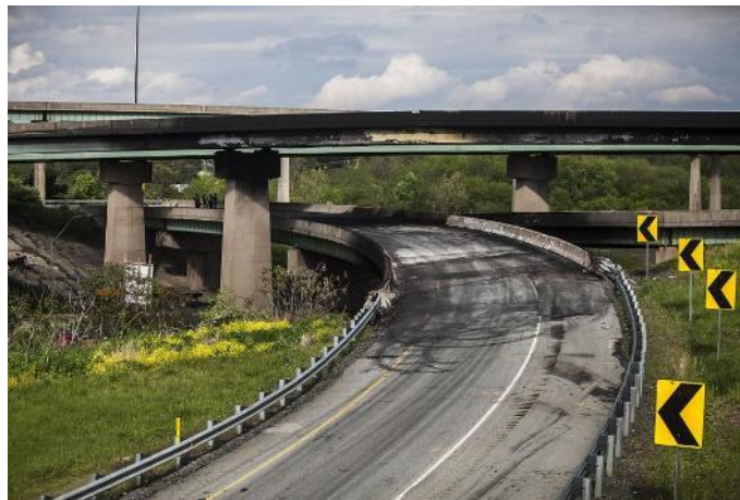
Fig. 1. Puente dañado por incendio de un tanque cisterna. Fuente: [2].
