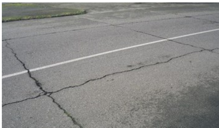
Figura 11. Fisuración por reflexión de juntas
