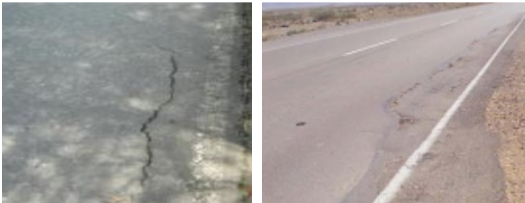
Figura 10. Fisuración de borde
