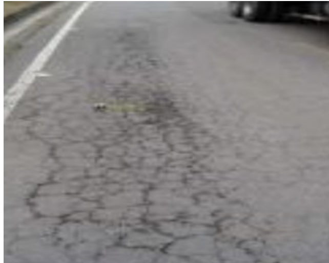
Figura 9. Fisuras por fatiga de la mezcla
