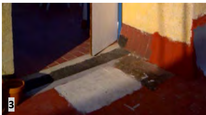
Il·lustració 25- Fotografies deficiències paviment general de coberta
