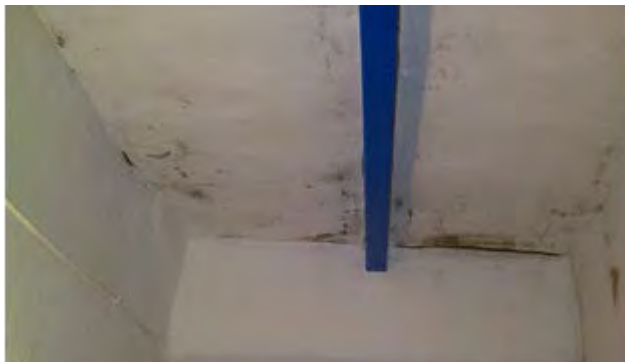
Il·lustració 37-Fotografia deficiència condensacions lavabo HPBD
