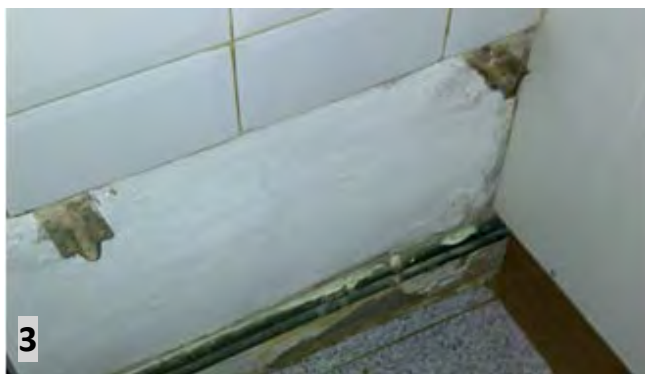
Il·lustració 30-Fotografies deficiències filtracions HPSD
