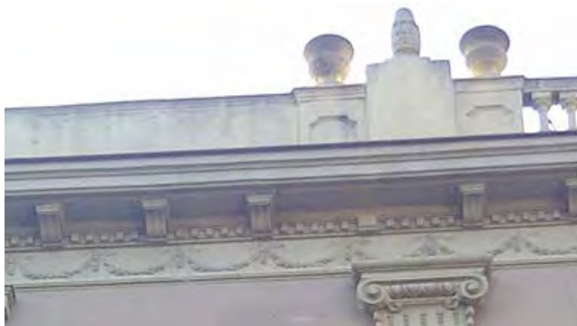
Il·lustració 20-Fotografia deficiència barana coberta a façana
