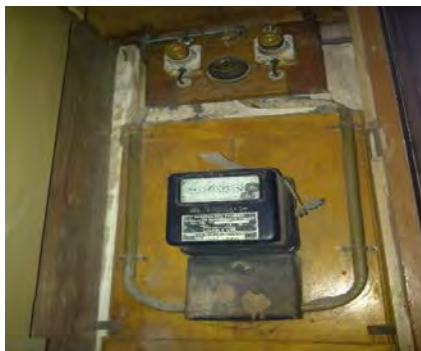
Il·lustració 15-Fotografia comptador elèctric escala-FP-2017
