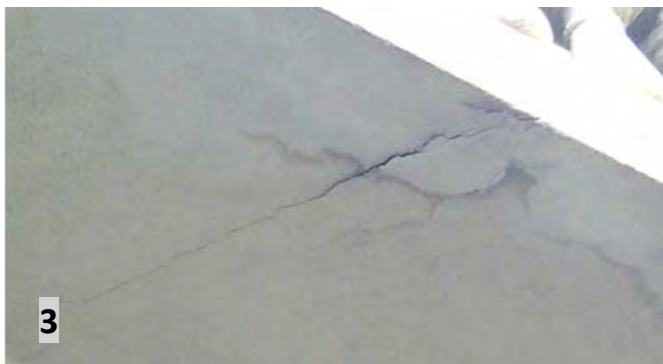
Il·lustració 19-Fotografia deficiències voladís balcons
