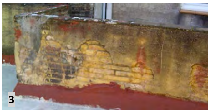
Il·lustració 23-Fotografies deficiències barana de coberta a patis
