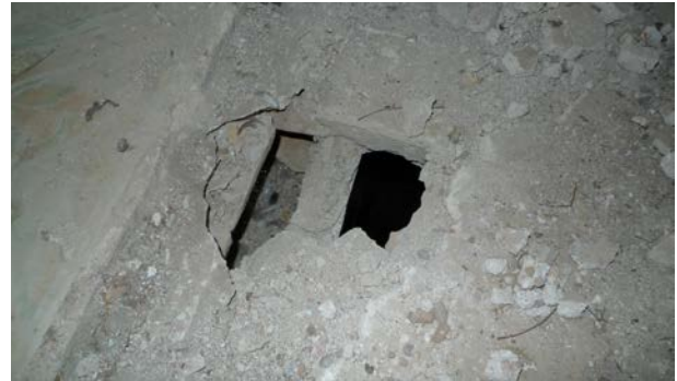
Figura 37. Cata sobre revoltón cerámico en apoyo de viga.
