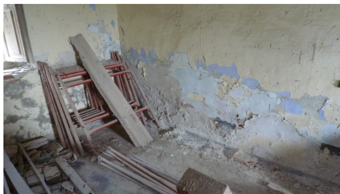
Figuras 98. Humedades por capilaridad en fachada norte Bloque 3
