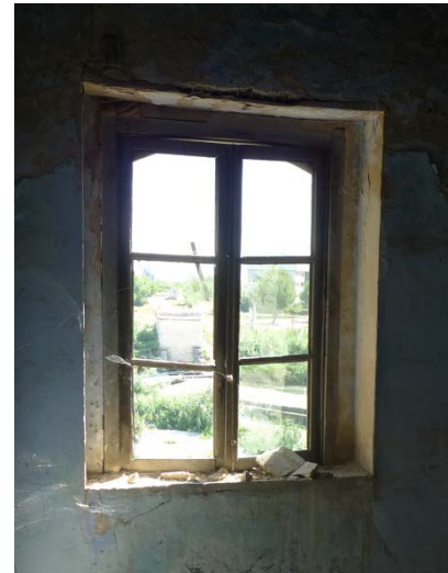
Figuras 95. Posible hinchazón del dintel de madera
