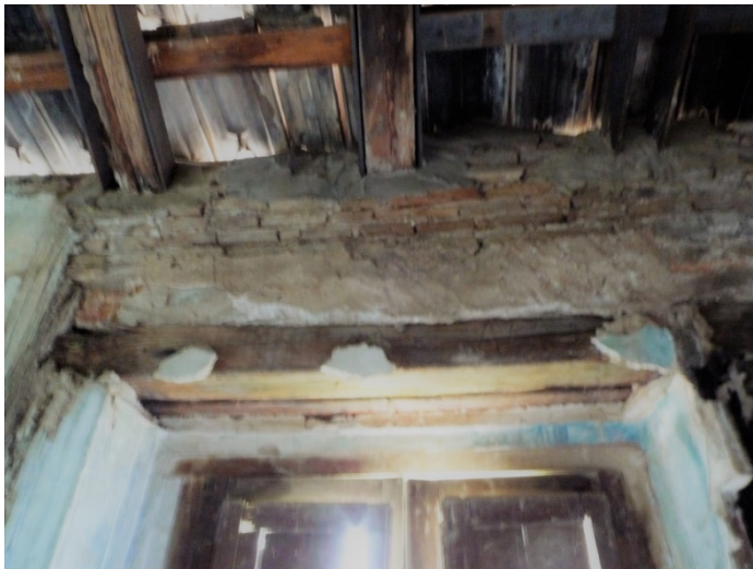
Figuras 94. Vista de dintel en mal estado
