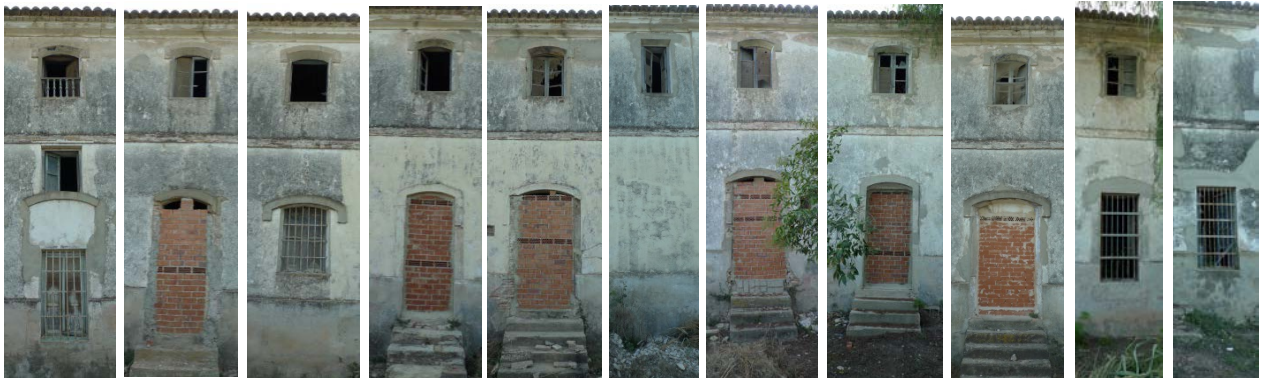
Figuras 105 a 115. Disposición huecos alterados fachada Este Bloque 3
