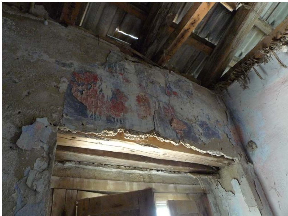
Figura 32. Dintel interior de madera. Bloque 3
