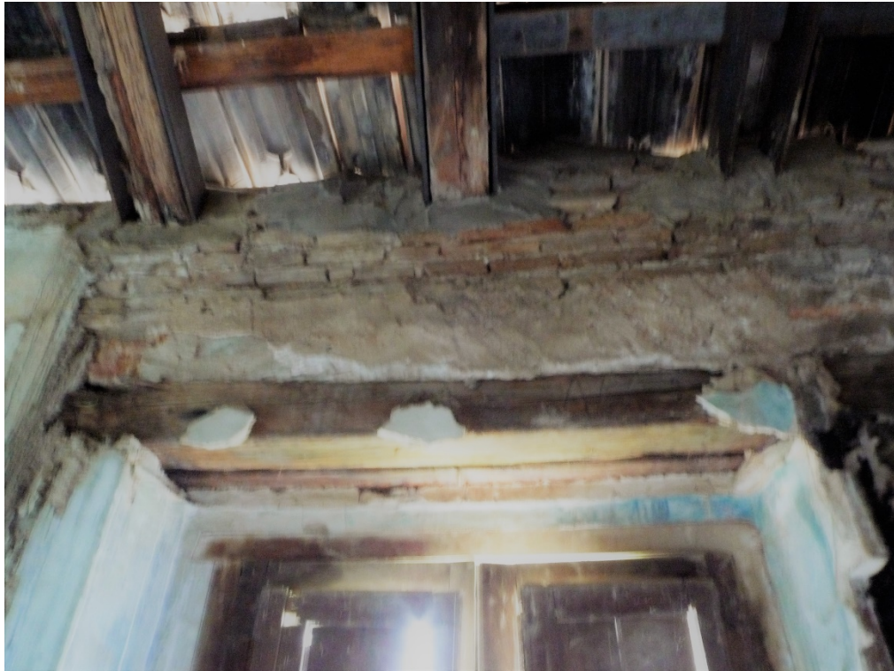
Figura 31. Dintel interior de madera. Bloque 3
