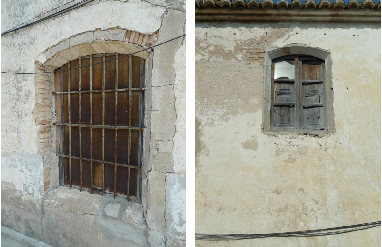
Figuras 33 y 34. Detalle machón lateral exterior y arco rebajado a modo de dintel por el exterior
