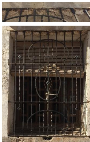
109. Reja oxidada. 2017. Fuente: Autor.
