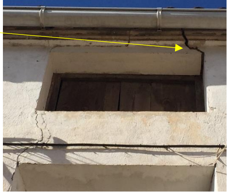
090. Grieta en fachada principal. 2017. Fuente: Autor.
