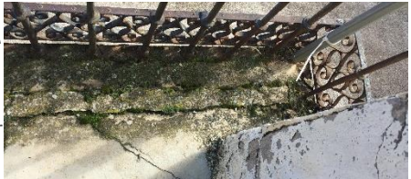
95. Forjado de balcones afectados por la corrosión. 2017. Fuente: Autor.
