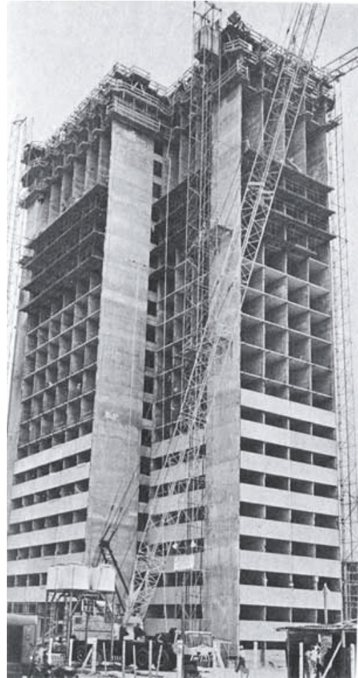
125. Edificio de 20 plantas en construcción con el Sistema de Moldes Deslizantes. (JR)
