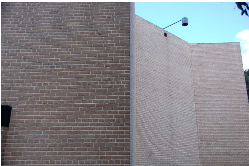
Figura 4. 37. Detalle de la pared exterior sur donde se observa su forma angulada y la colocación de los ladrillos exteriores.
