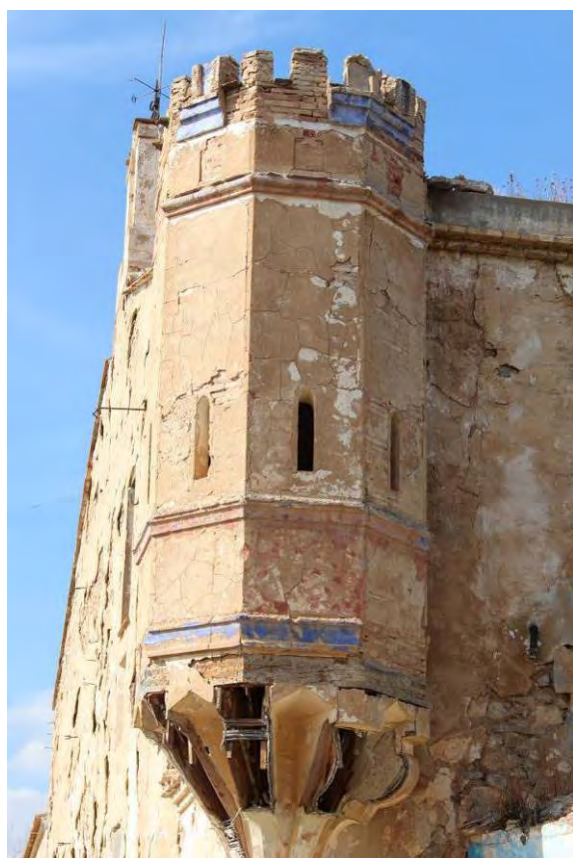
Fig. 64. Detalle garitón de esquina ya muy deteriorado
