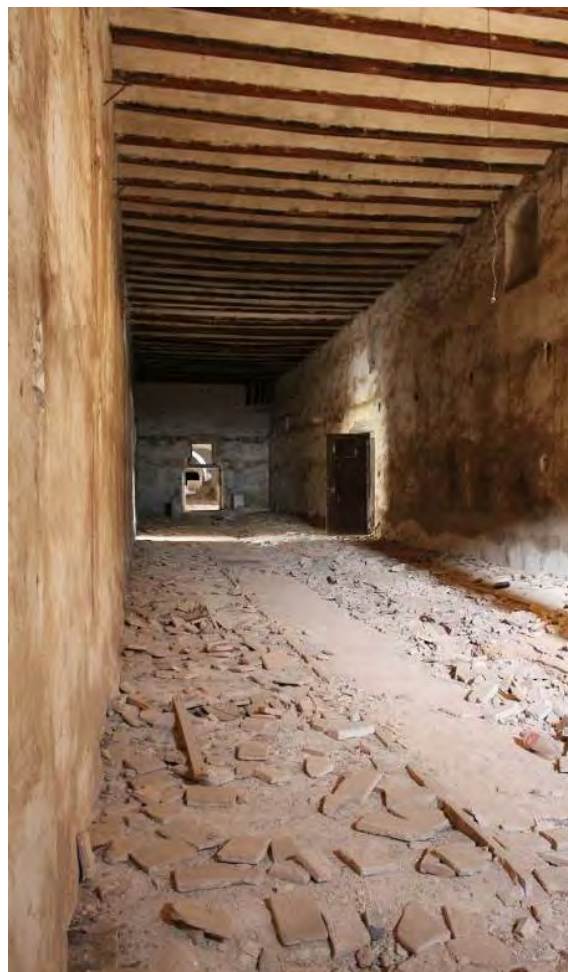
Fig. 84. Bodega en tercera crujía de planta baja
