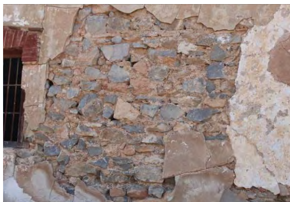
Fig. 81. Mampostería de fachada principal que se muestra al desaparecer el revestimiento
