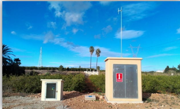
Figura 11. Boca de incendio y surtidor de toma.
