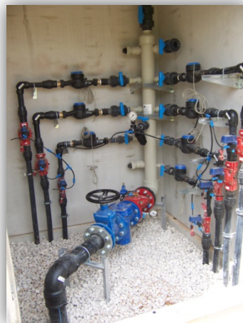
Figura 3. Hidrante instalado en la CCRR L'Alcúdia.
