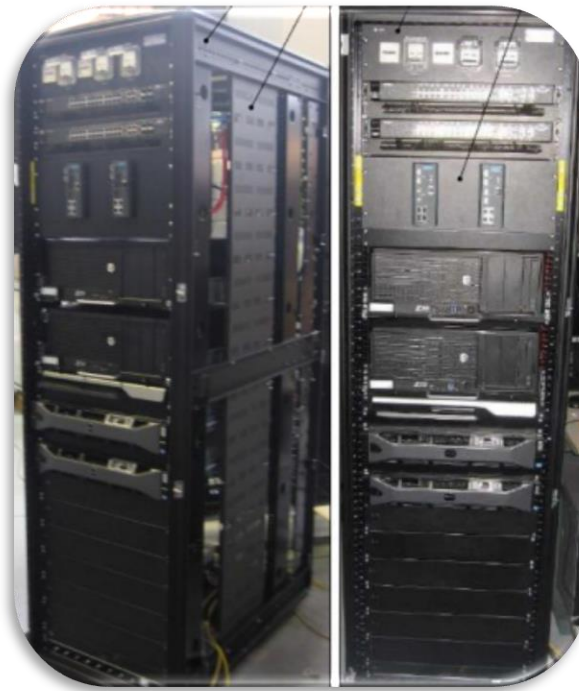
Figura 14. Estación central de procesamiento en un sistema de multilateración.
