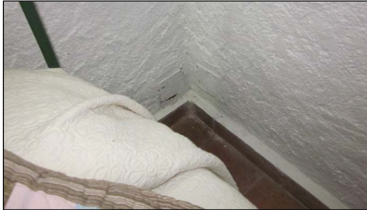
Figura 97. Rejillas ventilación casa-cueva nº5.
