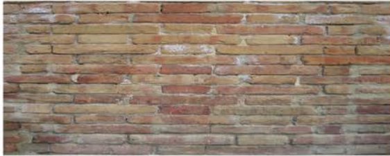
Imagen 8. Eflorescencias. Fuente propia.
