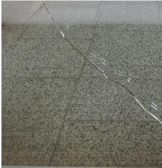
Imagen 71. Rotura vidrio laminar. Fuente propia.
