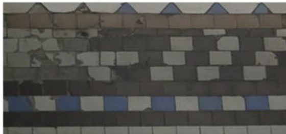
Imagen 42. Rotura y desprendimiento. Fuente propia.
