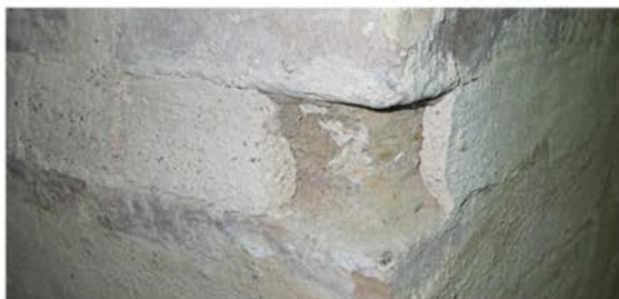
Imagen 4. Rotura de piezas. Fuente propia.
