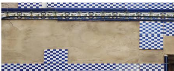
Imagen 20. Desprendimiento de piezas. Fuente propia.
