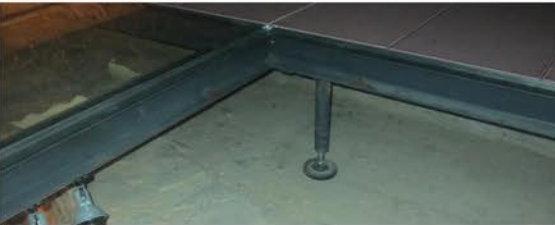
Imagen 79. Suelo técnico. Fuente propia.
