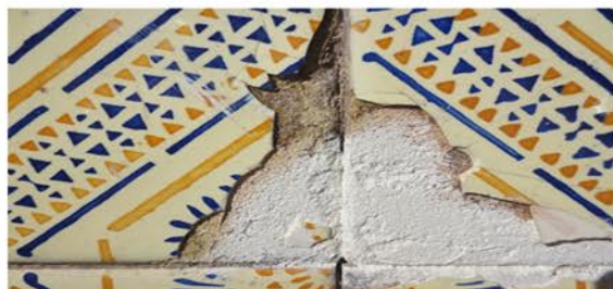
Imagen 21. Rotura de piezas. Fuente propia.
