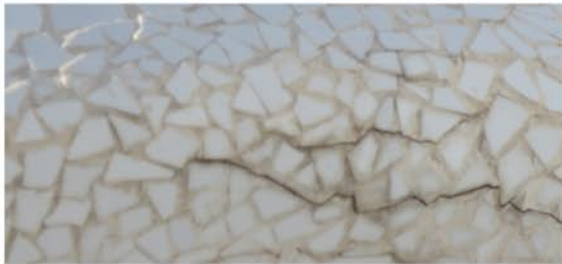
Imagen 37. Grietas. Fuente propia.
