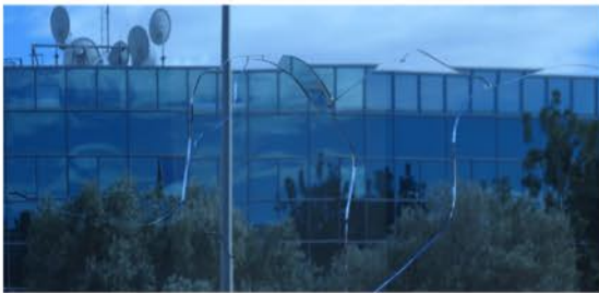
Imagen 69. Rotura vidrio. Fuente propia.
