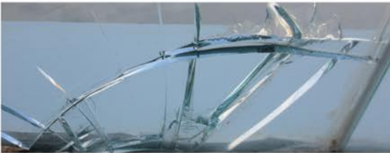
Imagen 76. Rotura vidrio laminar. Fuente propia.
