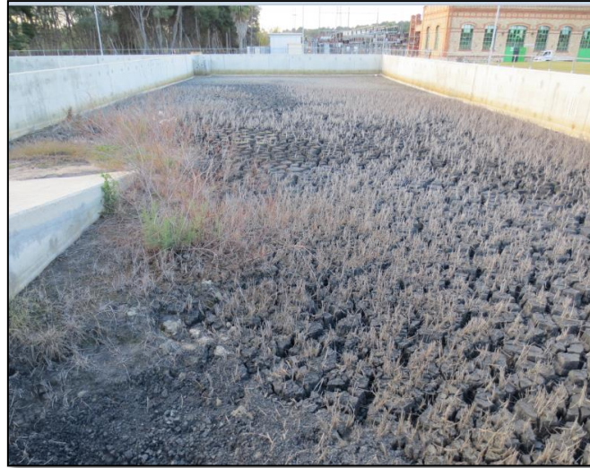
Figura 4.1. Sitio de disposición para el secado de los lodos en la ETAP La Presa.
