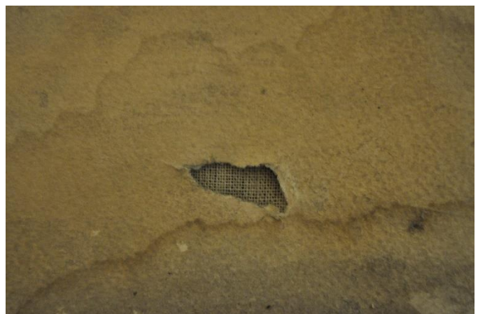
Figura 32: Un faltante del soporte del cartel. Fuente: I. Herrero
