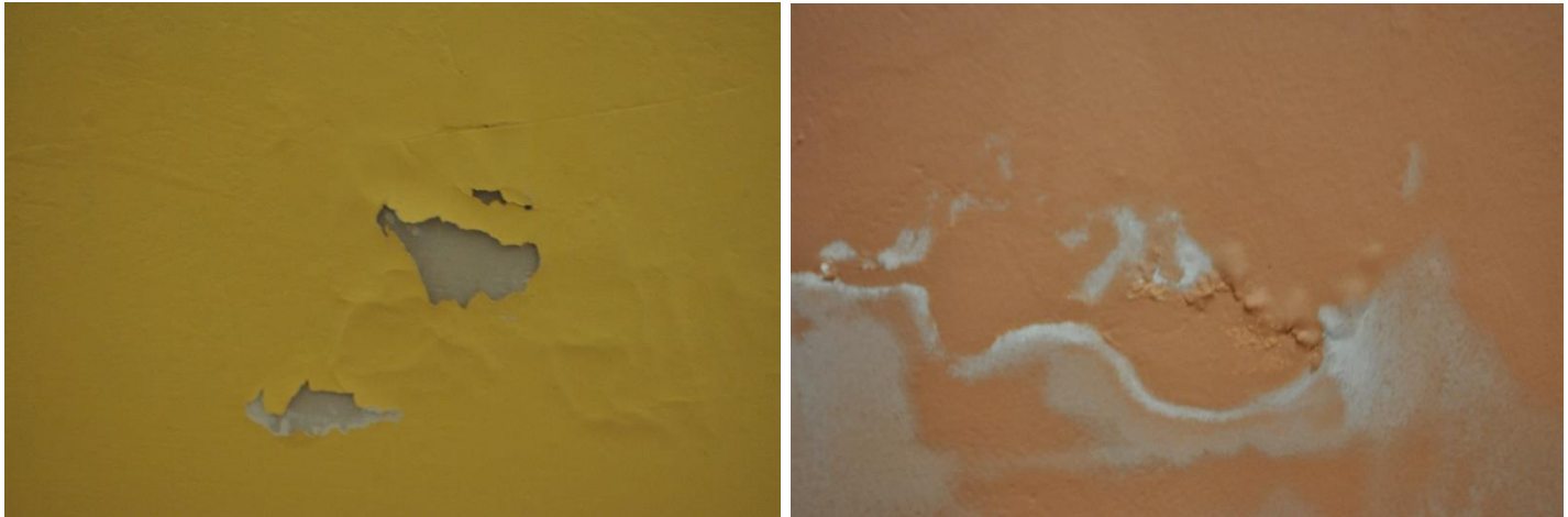
Figuras 16 y 17: Pared del museo con deterioros como desconchados y sales producidos por la humedad por capilaridad.
