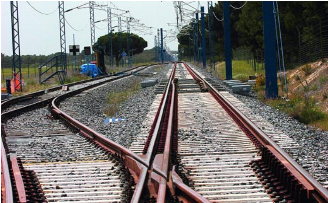
Figura 5.8: Imagen de desvío y cambiador de hilo. Fuente: ADIF.
