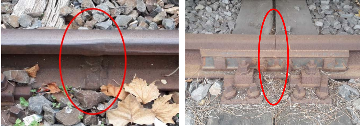
Figura 2.17: Imágenes de carriles. Soldadura (izquierda), junta embridada (derecha). Fuente: Elaboración propia.
