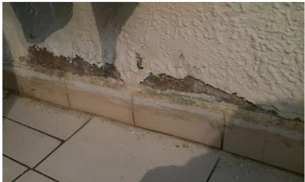
Figura 54. Humedad en la pared del pasillo de planta baja. 2017. Fuente: Autor.
