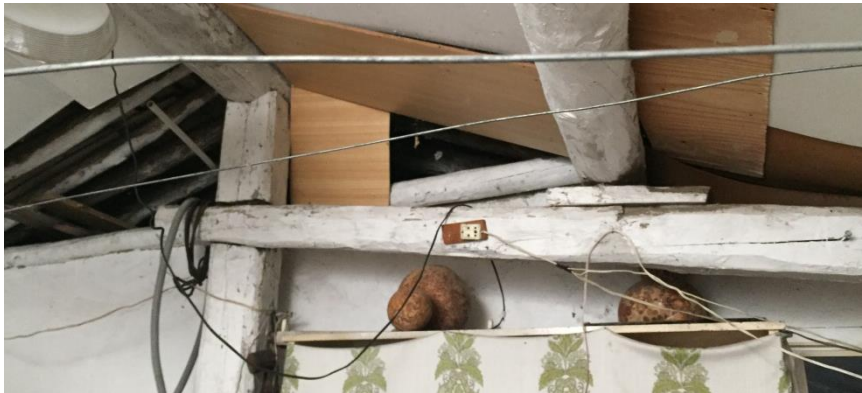
Figura 61. Instalación eléctrica en planta segunda. Fuente: Autor.
