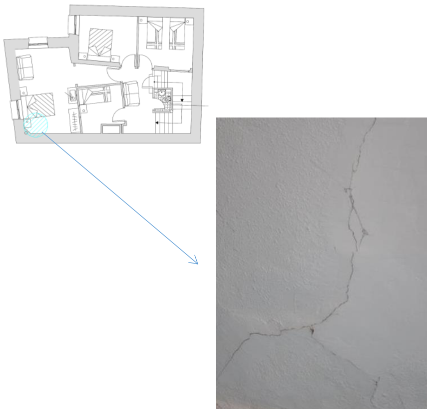
Figura 60. Fisuras/grietas en una habitación en planta primera. 2017. Fuente: Autor.
