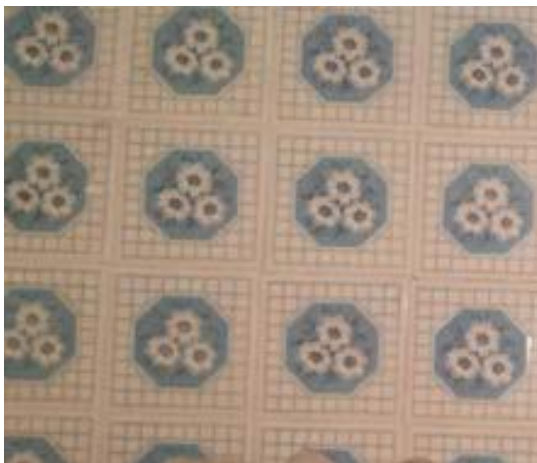
Figura 40. Alicatado baño. P.B. Fuente: Autor.
