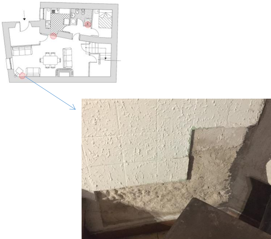
Figura 56. Desprendimiento de azulejos en pared del comedor en planta baja. 2017. Fuente: Autor.
