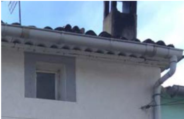
Figura 37. Evacuación de aguas pluviales fachada. Fuente: Autor.
