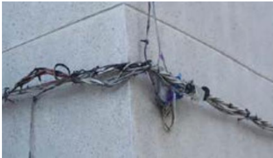
Figura 36. Instalación eléctrica fachada. Fuente: Autor.
