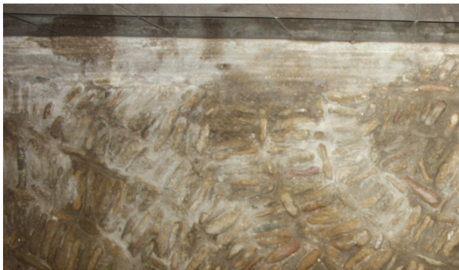
Fig. 30: Aparición de sales solubles, sobre todo en las zonas cercanas a paredes.
