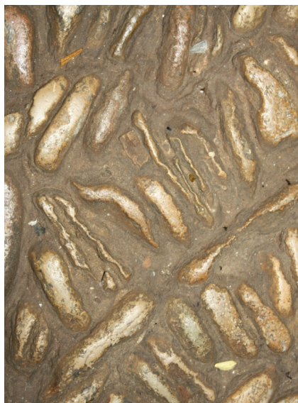
Fig. 27: Fisuras y roturas en los cantos.
