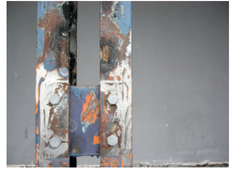
15. Arriostamiento del pilar de planta baja 15. Herringbone strutting on ground floor pillar
