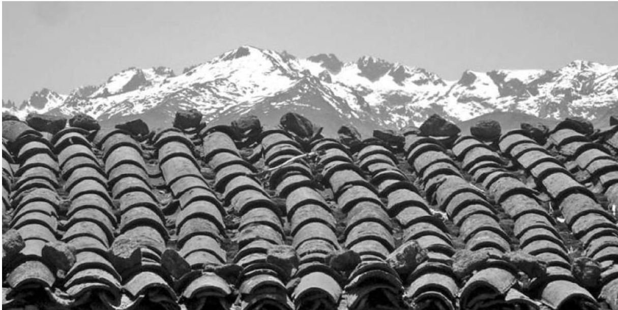
Figura 24. Barreras de viento con piedras para evitar la succión del mismo.
