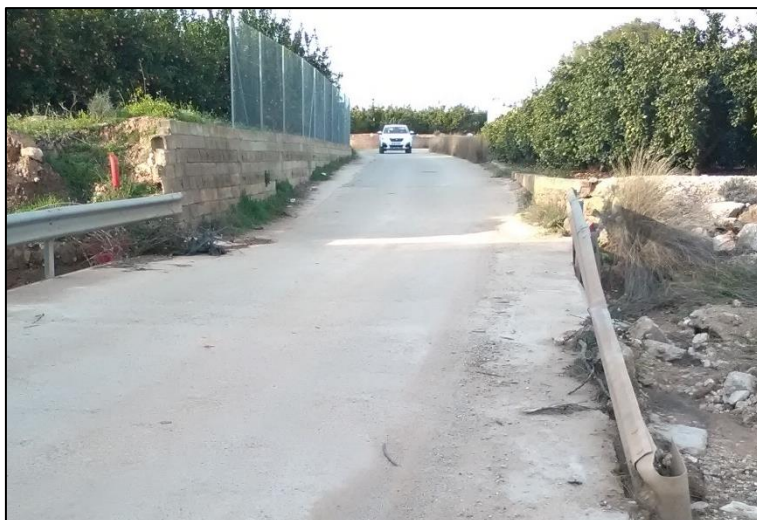
Fotografía nº 8: Cerramiento de parcelas afectados por la ejecución de las obras.
