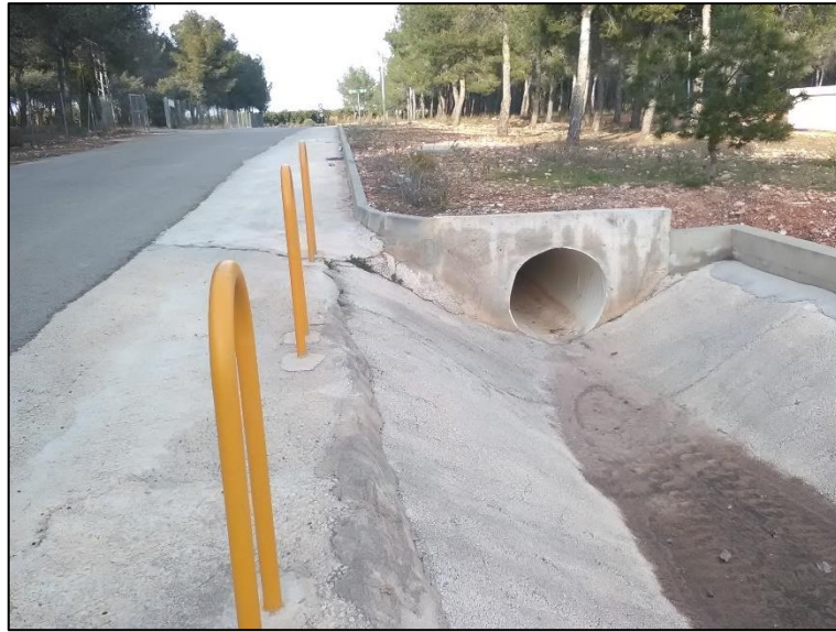
Fotografía nº 4: Punto finalización cunetón de hormigón e inicio de la conducción tipo Ribloc.
