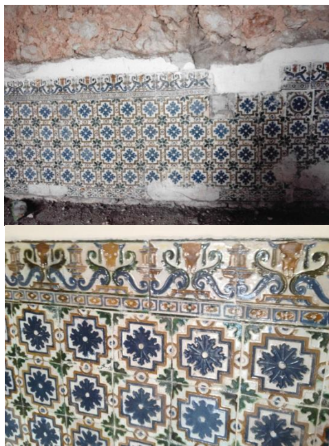
Fig. 10- Zócalo de azulejos, antes y después.
