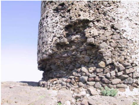
Fig. 15 – Torre di Foghe, erosion at the base
