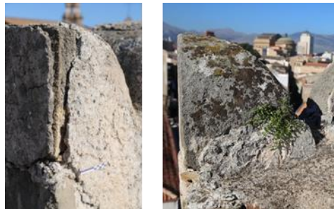
Fig. 7 - Intonaco distaccato e degrado biologico.
