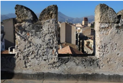
Fig. 5 - Superfici degradate dei merli.
