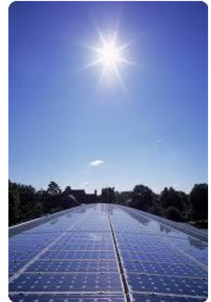
Figura 12.1: placas solares fotovoltaicas.
