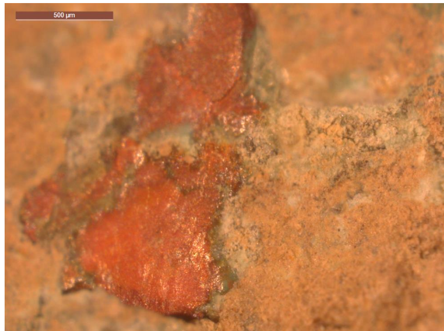
Figura 14. Fotografía macro de patologías. Depósitos de cuprita (color rojizo) y malaquita (verde)
