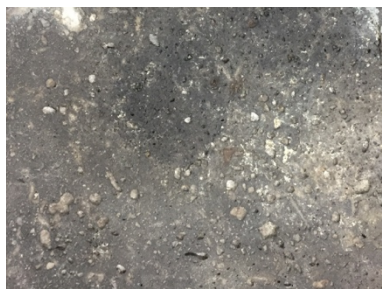
Fig. 10.. Estado de la superficie de la pieza.
