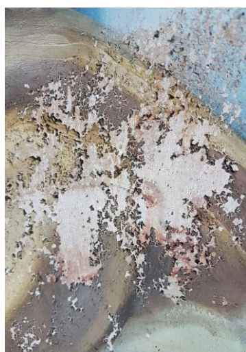
Fig. 51. Desconchados y pérdidas en la cúpula provocados por la humedad.
