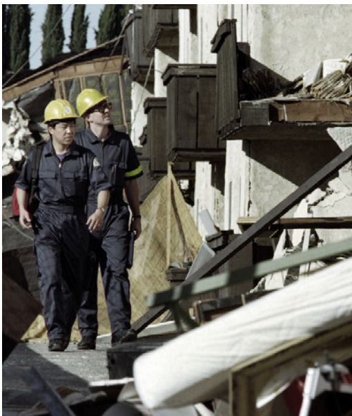
Imagen 6.4. Revisión de desperfectos en Northridge, EEUU.
