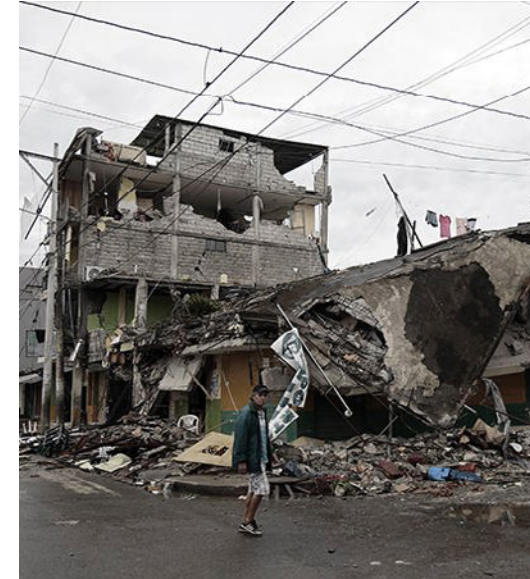
Imagen 7.5. Edificios derribados debido al terremoto en Ecuador 2016.
