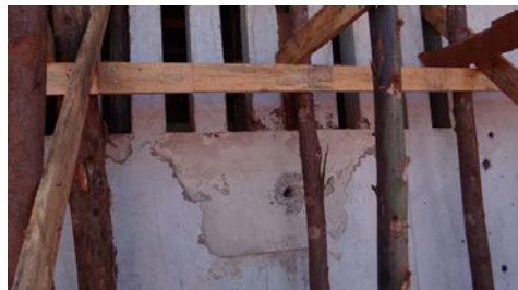
(a) deficiência e reparo na parede concretada com concreto convencional.
