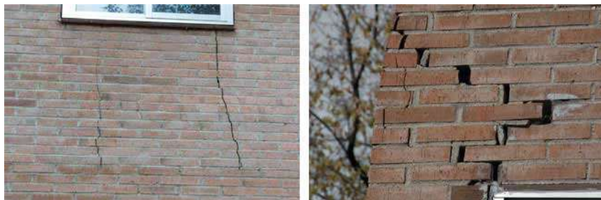
Imágenes 33 y 34: Aparición de grietas en fachada.
