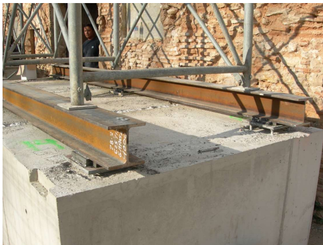
Imagen 69: Ejemplo de anclaje de una estructura metálica de un estabilizador de fachada al lastre del mismo. El ejemplo de la imagen es de un estabilizador de fachada situado en la localidad de Silla.
