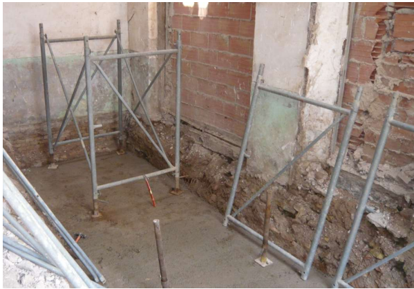
Imagen 26: Ejemplo de estructura metálica (con el método del sistema tubular) embebida en el lastre de hormigón.
