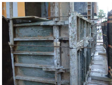
Imagen 19: Encofrado para lastre de hormigón vertido in situ solucionado con tableros fenólicos.
