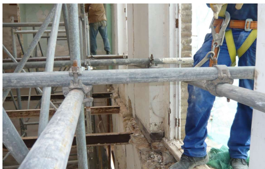
Imagen 71: Montadores de un estabilizador de fachada arriostrando la estructura metálica a la fachada con todos los equipos de protección individual (EPIs) necesarios colocados.
