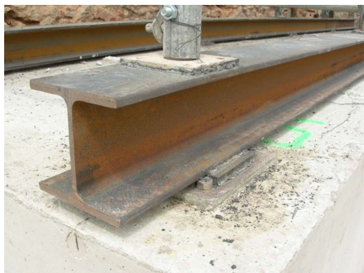
Imagen 72: Perfil metálico soldado a las placas niveladas y embebidas en el dado de hormigón.
