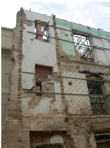
Imagen 75: Ejemplo del arriostamiento entre la estructura metálica del estabilizador de fachada y la propia fachada a estabilizar.
