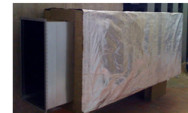
Conducte ventilació EI120
