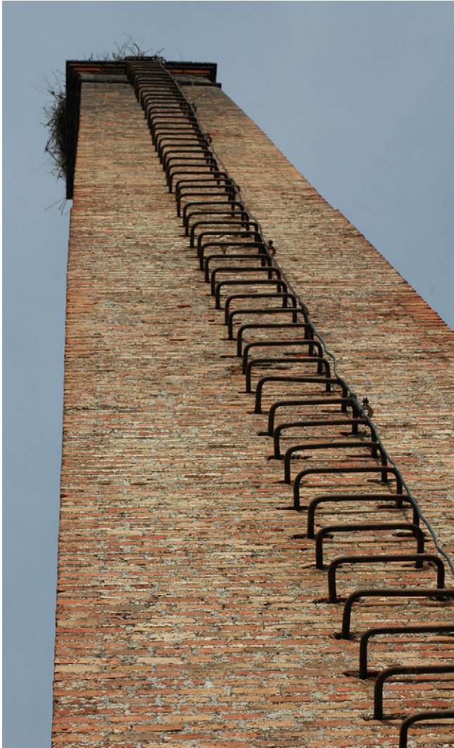
Figura 11. Anillas exteriores en forma de [ de la chimenea Electro Harinera Panificadora. Almodóvar del Campo (Ciudad Real).
