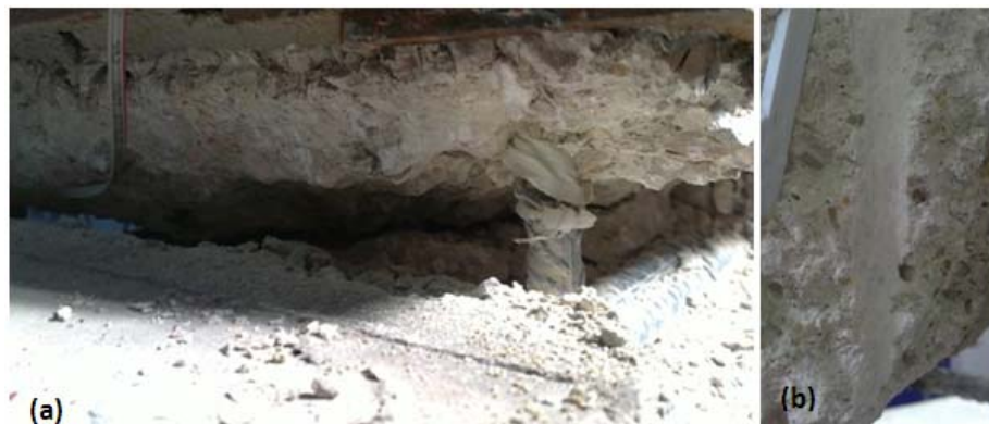
Fig. 6.8. Pérdida de adherencia armadura pilar
