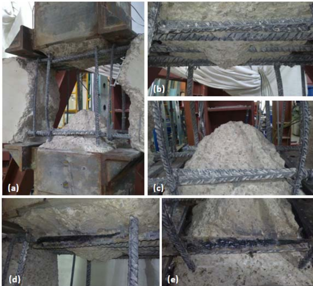
Fig. 6.21. Reparación de probeta A.VB.L1-R. a) Vaciado del material dañado del nudo, b) vista de armaduras superiores de viga, c) vista de armaduras inferiores de viga, d) y e) soldadura de armaduras solapadas superiores e inferiores
