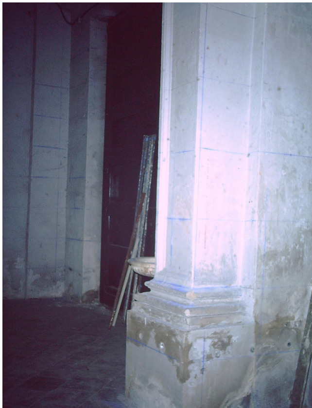
Fig. 5.7.: Muro Iglesia de San Pablo de los Jesuitas. I.N.E.M. Luis Vives. Valencia. Investigación realizada con este procedimiento. Malla dibujada perimetralmente a las piezas que sobresalen, con tiralíneas y azulete. Ver Cap. 9.3. Fuentes propias.
