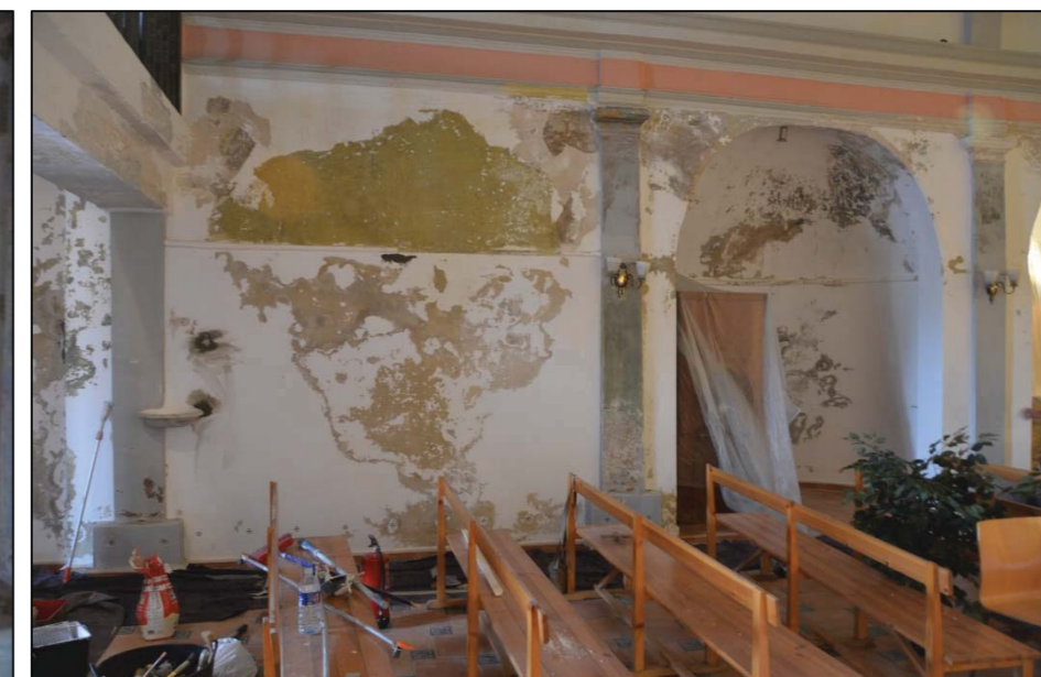
Interior Ermita de Vera-Vista de muro lateral afectado por humedad capilar.
