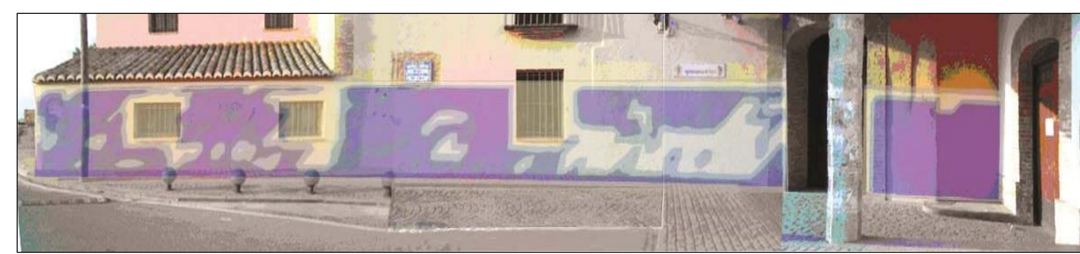
FOTOGRAFÍA DIGITAL + MAPEO DE HUMEDADES
