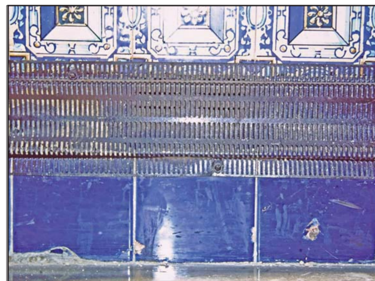
Rejilla metálica que oculta perforaciones en muro para ventilación colocada en cara exterior de muro recayente al Claustro del Instituto.
