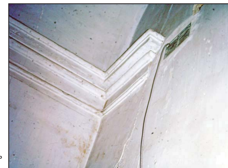
Rejilla de ventilación/aireación Knapen colocada en la parte superior muro a cara interior del muro.
