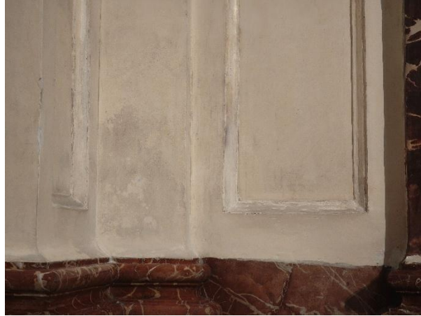
Figura 30. Eflorescencias y manchas de humedad. Fuente: elaboración propia.
