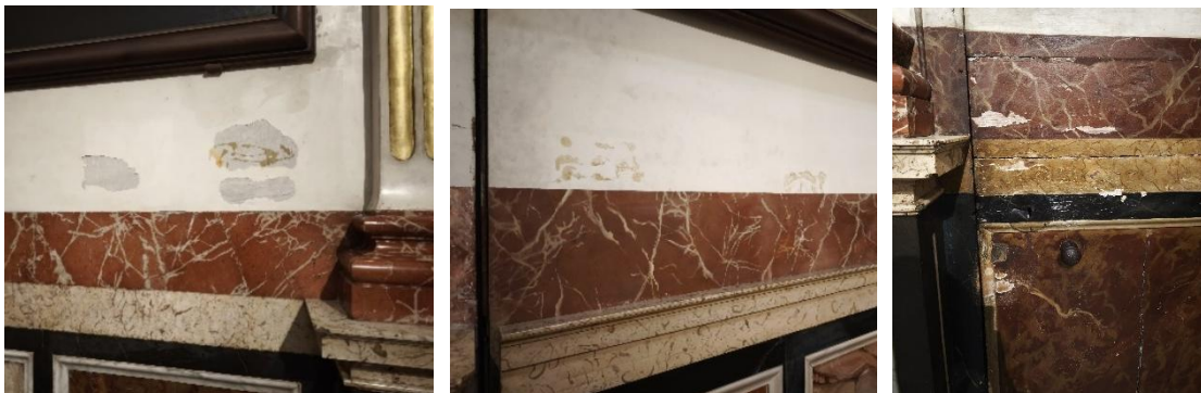
Figura 29. Desprendimientos y abrasiones en zonas enlucidas y también en la pintura que imita al mármol rojo y policromías doradas en las puertas de la capilla que dan hacia estancias internas de la catedral. Fuente: elaboración propia.
