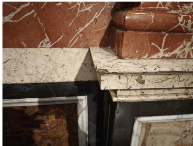
Figura 27. Pérdidas materiales en las esquinas del mármol Fuente: elaboración propia
