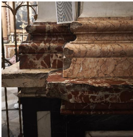
Figura 26. Pérdidas materiales en las esquinas del mármol Fuente: elaboración propia
