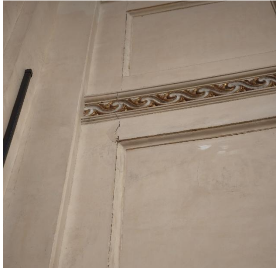
Figura 28. Fisuras y microgrietas localizadas en los apliques de yeso y elementos decorativos Fuente: elaboración propia.
