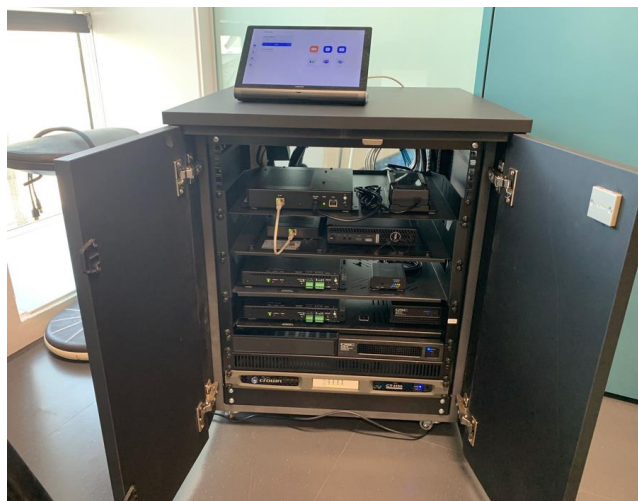
Figura 62. Rack dedicado al hardware.
