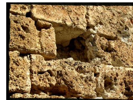
Sillar desaparecido al Sur del transepto.
