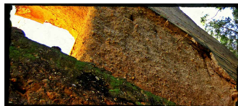
Desprendimiento de la costra superficial en la cara Oeste de la torre.
