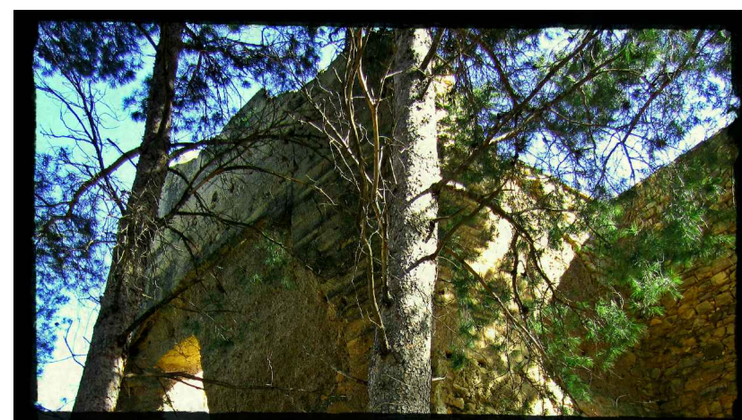
Árboles demasiado cercanos a la torre de tapial.
