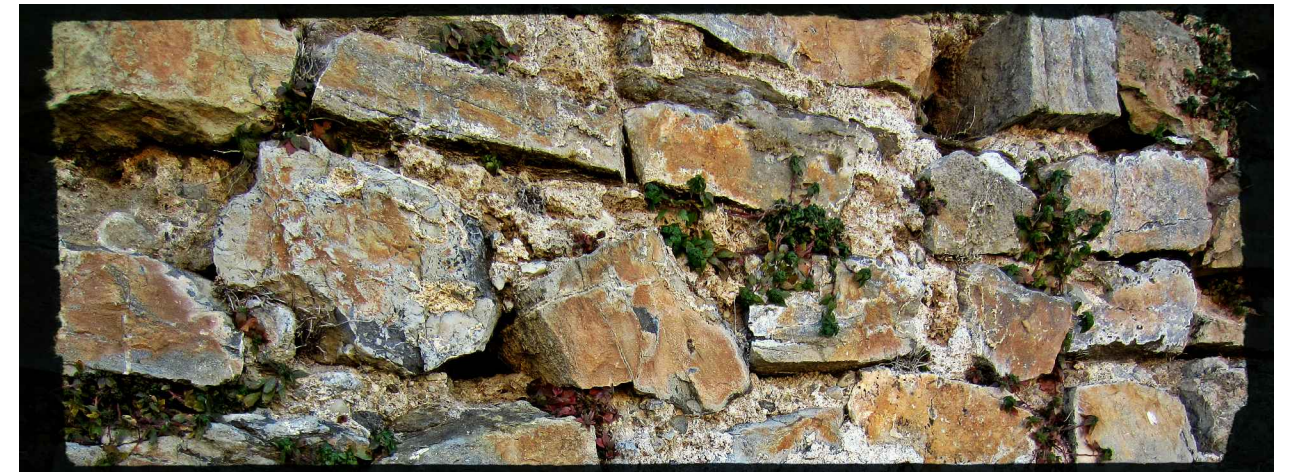
Rocas con fuerte presencia de costras, vaciado de juntas y vegetación superior.
