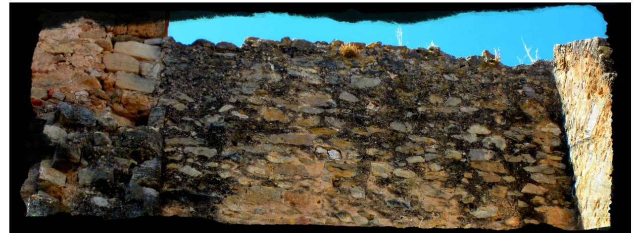
Muro ennegrecido del sector cían en la fachada Norte.
