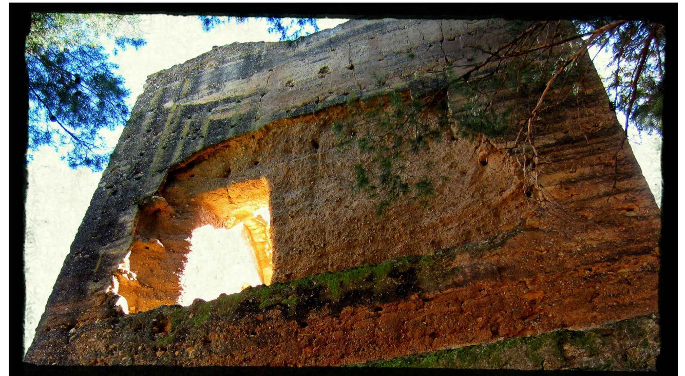
Muro de tapial en preocupante estado de conservación.
