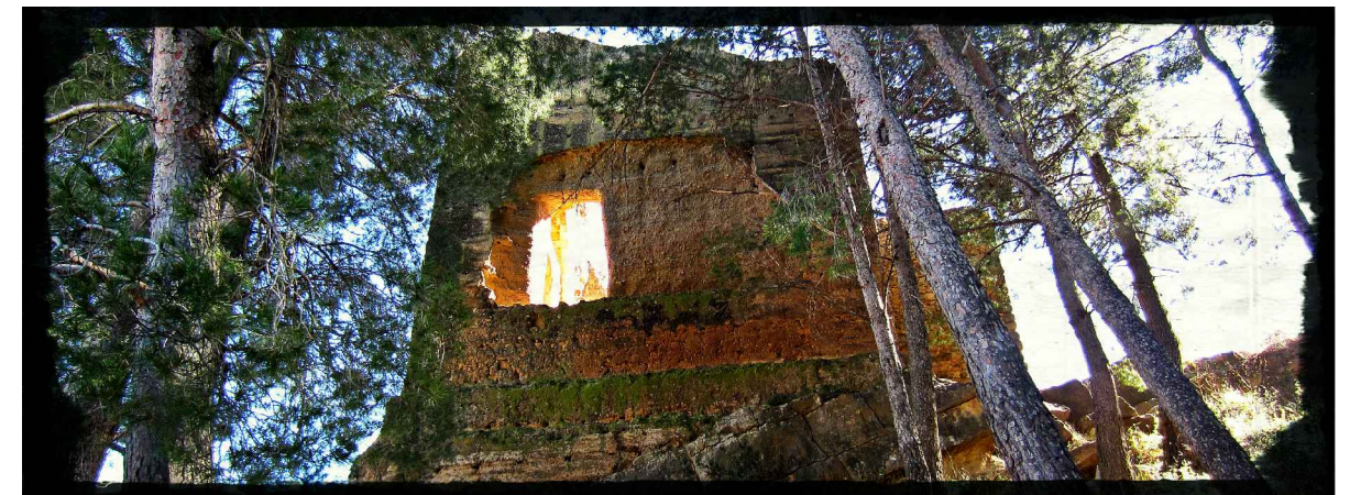
Torre de tapial con un gran desprendimiento de la costra superficial en su cara Oeste.
