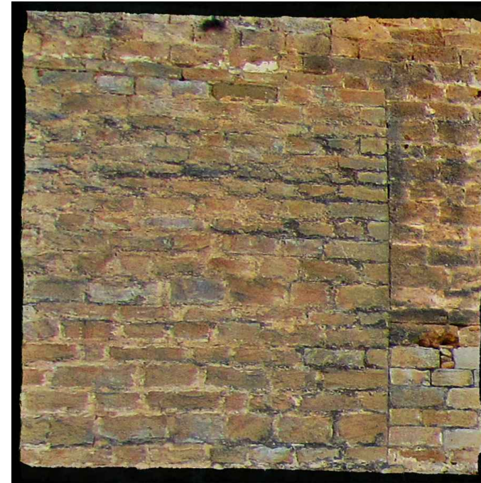
Fotos de ennegrecimiento en el sector naranja:
