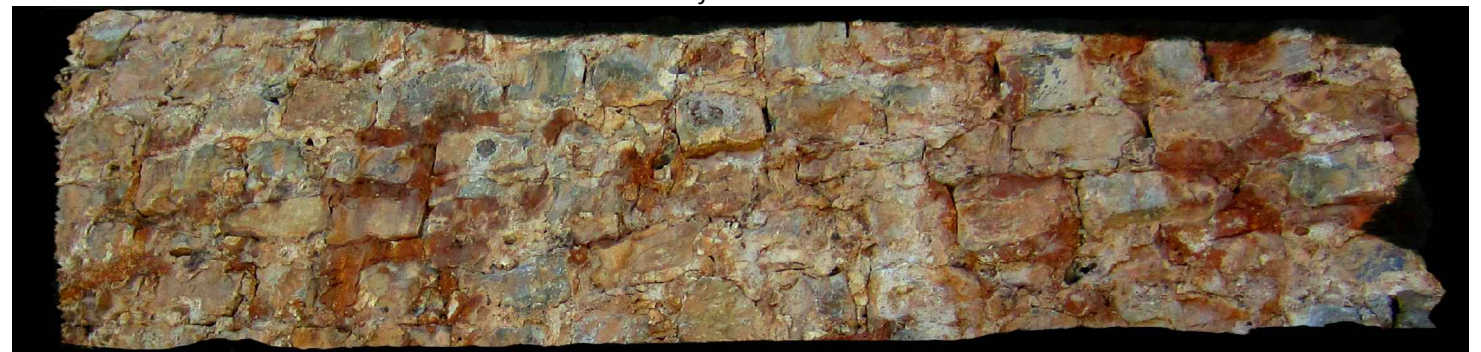
Manchas de humedad.
