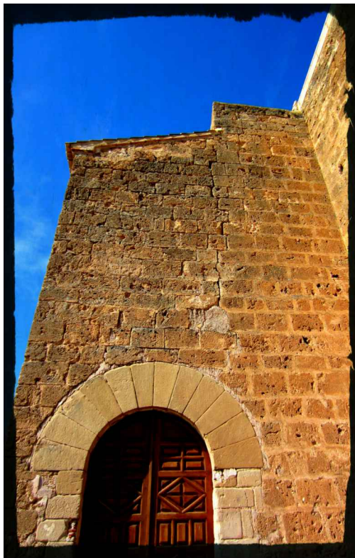
Grieta sobre la puerta de acceso.
