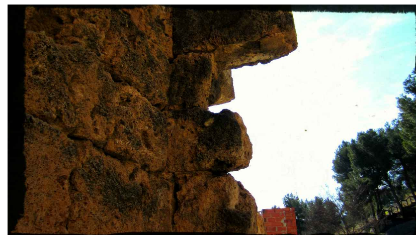
Sillares con riesgo de desprendimiento en el extremo del transepto.
