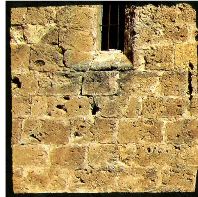
Fotos de grietas en el sector azul:
