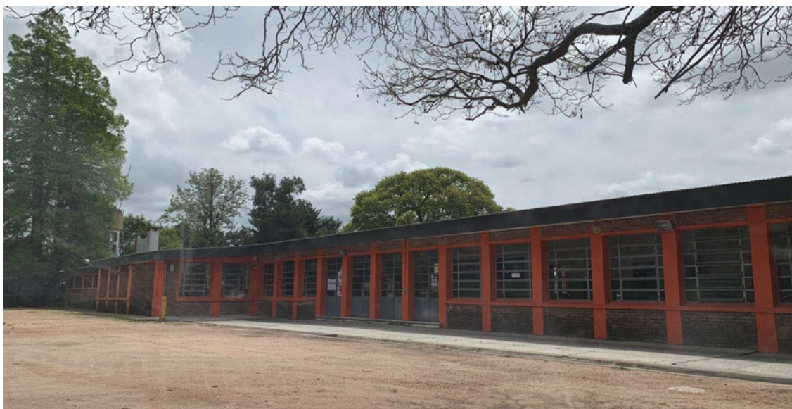
Fig. 8 Escuela Pública N° 157 Villa García (Municipio F), Fachada Principal dentro del predio. Fuente: Palermo Miserocchi, R (2021)
