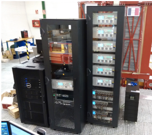
Figura 1.26: Los armarios electrónicos de NEW. Desde la izquierda, los ordenadores y los servidores, el plano de energía y el armario del plano de trazas. A cada lado de los armarios hay un SAI (Sistema de Alimentación Ininterrumpida), capaz de alimentar todo el sistema hasta 40 minutos en caso de una fallo eléctrico.
