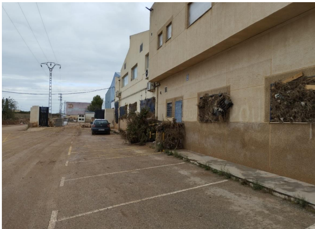
Imagen 93 : Marca visible del nivel máximo alcanzado por el agua en la facha. (Eguibar, 2024).
