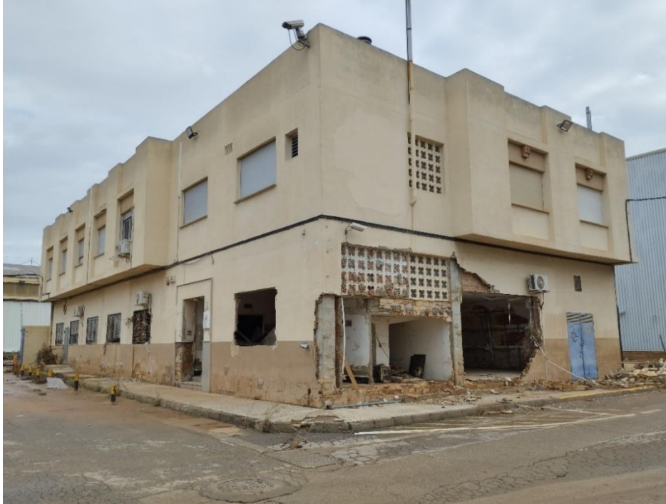
Imagen 91 : Daños en edificio industrial tras la DANA, con marcas visibles del nivel del agua y erosión en la base. (Eguibar, 2024).
