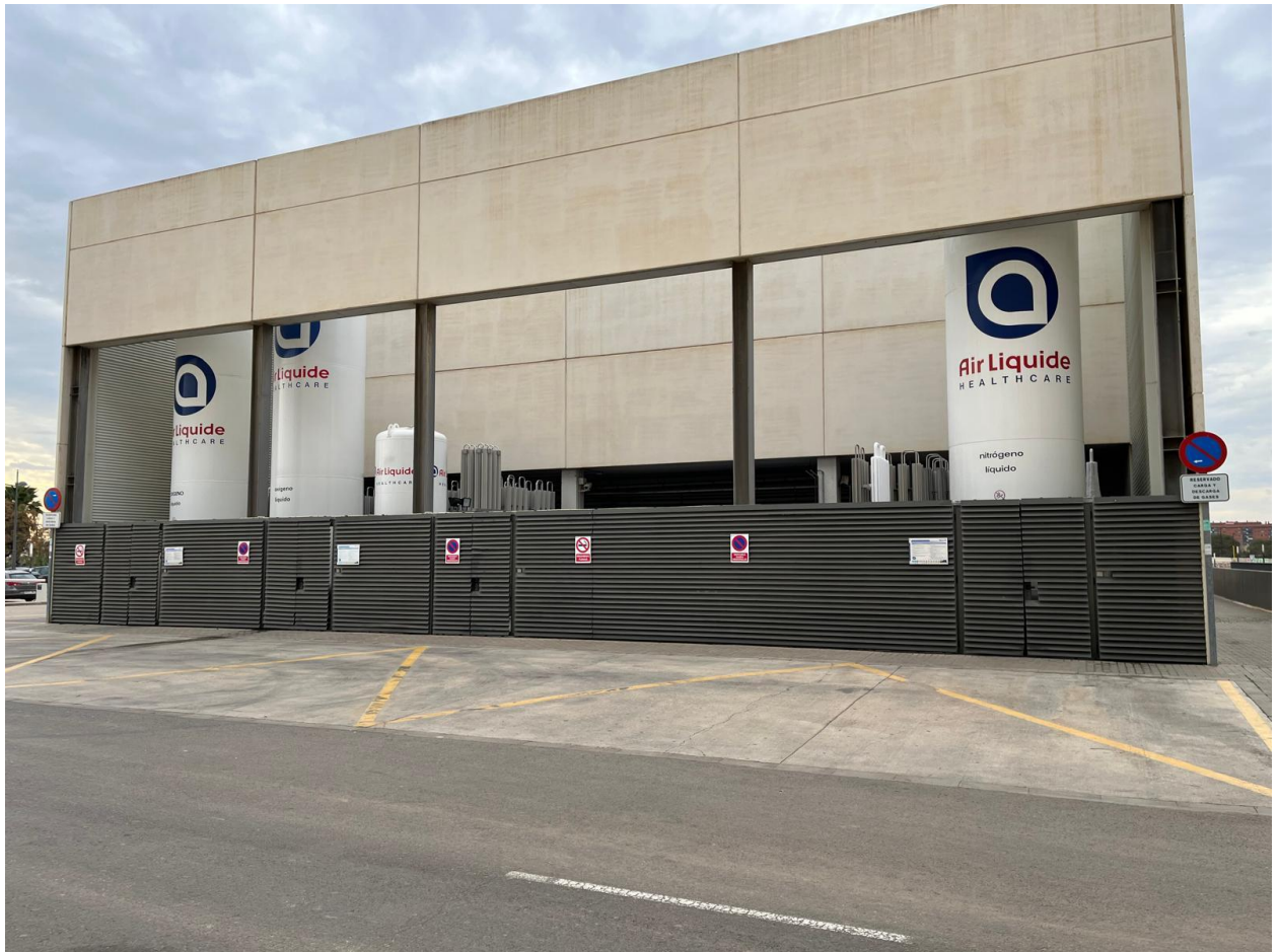
Fotografía 8 Acumuladores de gases clínicos, con zona de carga y descarga
